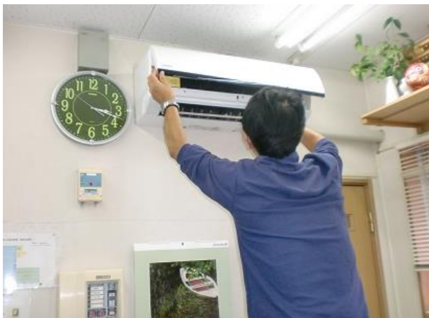
エアコンフィルターの清掃
